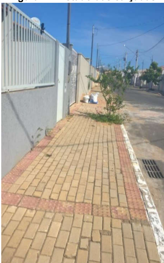
Figura 12: Estado das calçadas.
